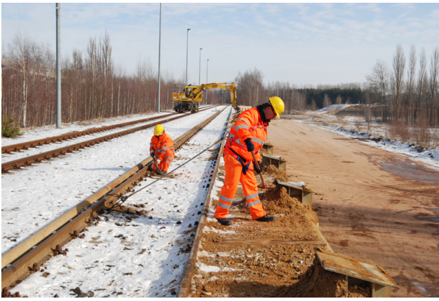
Absturzgefährdete Arbeiten am Rand einer Entladestelle in einem Wismut-Sanierungsprojekt. Foto: bgrci/ Soestmeyer
