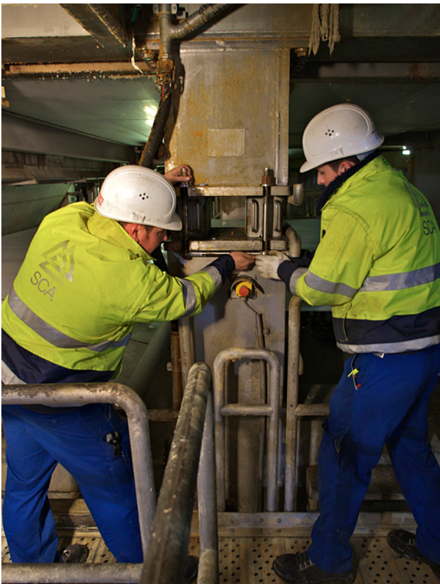
... müssen beim Bspannungswechsel der riesigen Maschinen zur Papierherstellung teilweise abgebaut werden. Das erhöht das Unfallrisiko.
