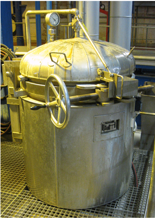
Gesamtansicht eines nachgerüsteten Filters
