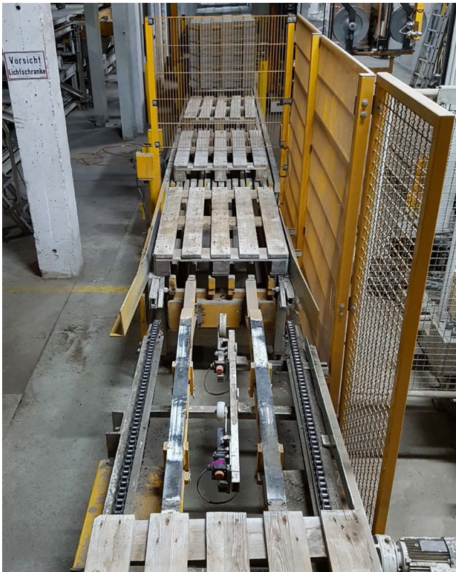
Übersicht des Palettenwegs in die Anlage
