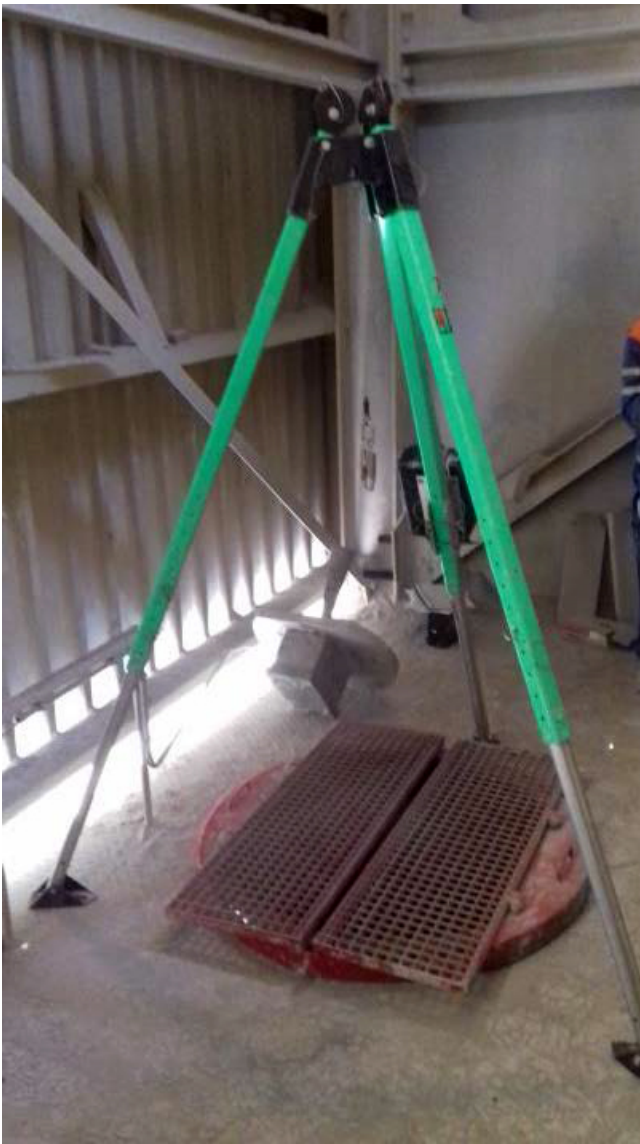
Neue Gitterrostabdeckung mit aufgebautem Dreibein
